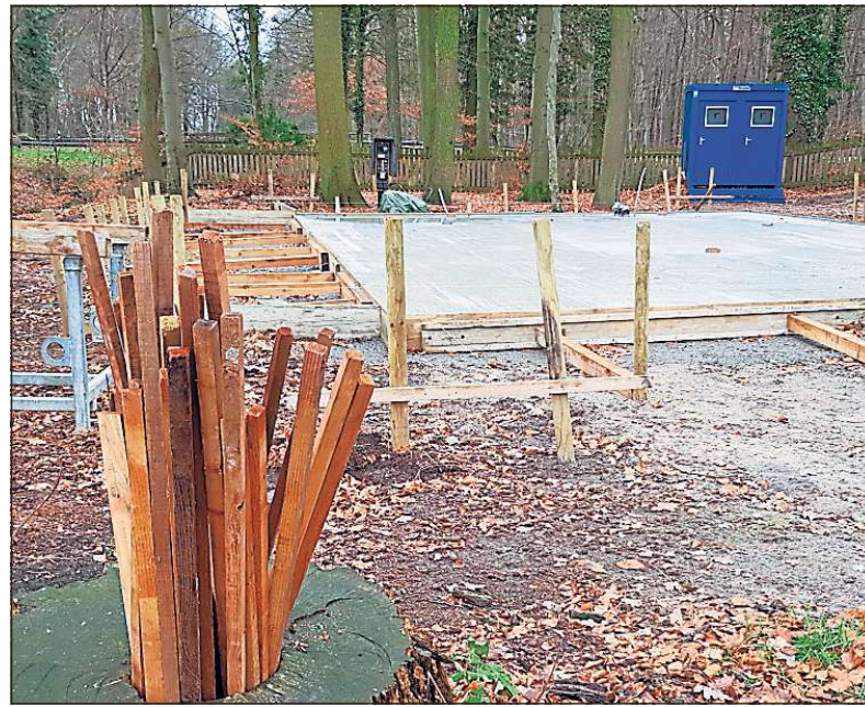
Dort, wo bis November noch ein einsturzgefährdeter Holzschober stand, ist am Dienstag die Bodenplatte gegossen worden.
